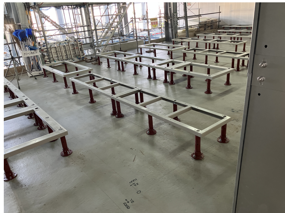
電気室仕上げ
