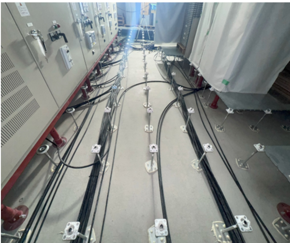
高圧電気室 配線
